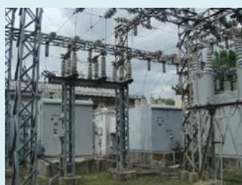
【旧吉田変電所】
