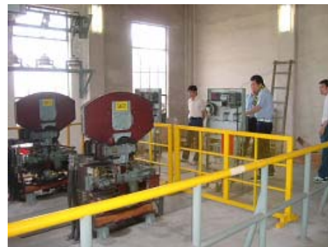
変電所施設の研修
