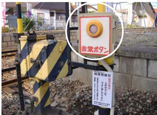
非常押しボタン
