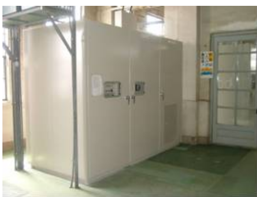
電力変換装置
